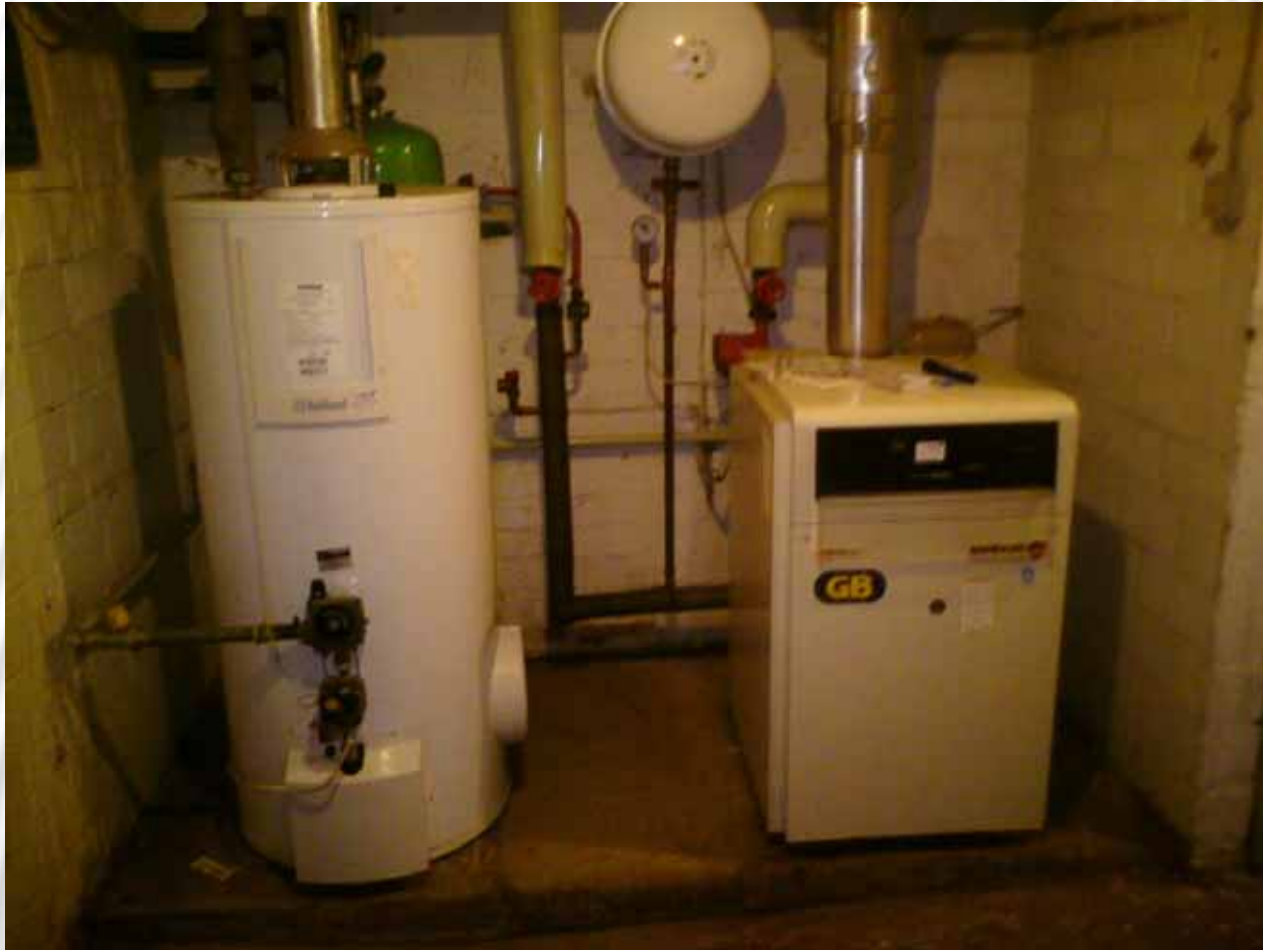
Kessel und Warmwasserbereiter Baujahr 1995
